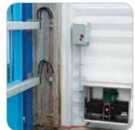
Centralita hidráulica MEC 700/80 VENTIL con doble depósito en el interior del armario de protección
